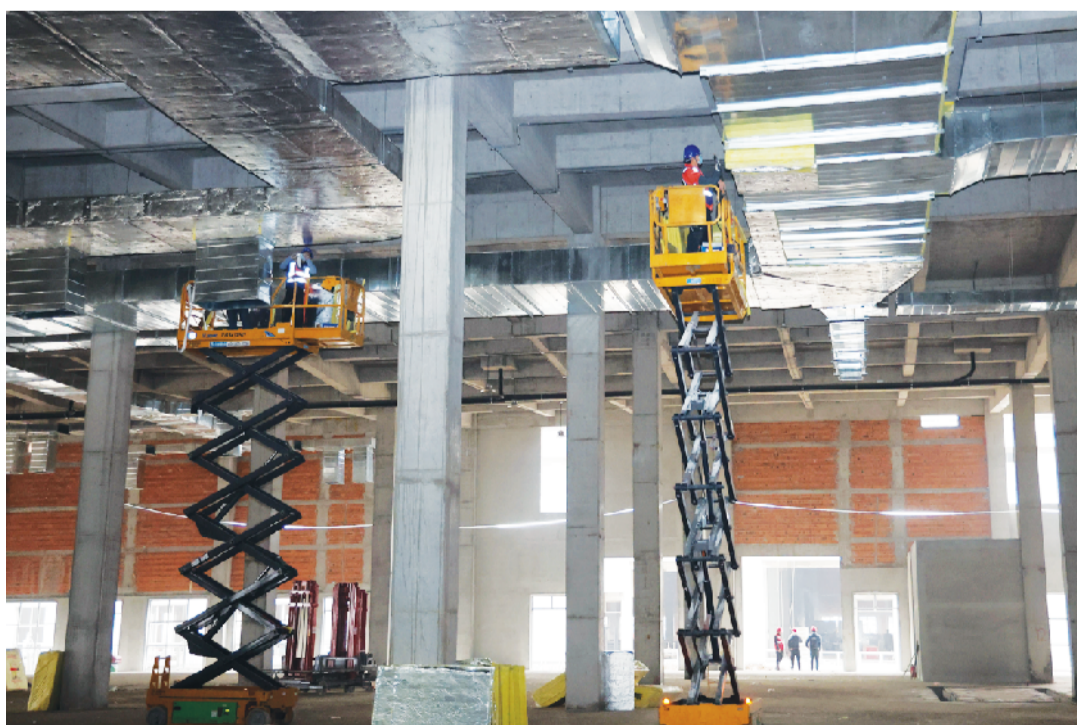
航天锂电淮南新桥50Gwh锂电池产业基地一期项目进入室内配套工程安装(2024年3月6日摄)
