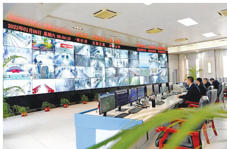
淮河能源控股集团煤业公司顾桥矿智能化调度指挥中心。
