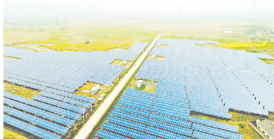
合肥首个地方光伏扶贫电站——巢坝镇石塘村集体电站。
