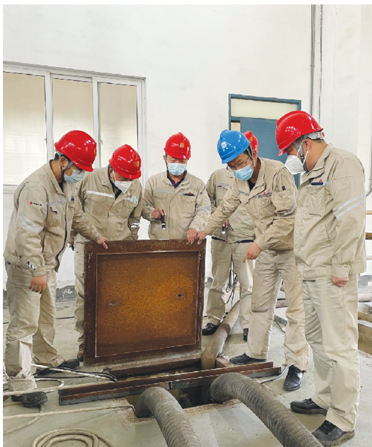
▲洛河发电厂技术人员检查5号机循环水泵检修情况。
